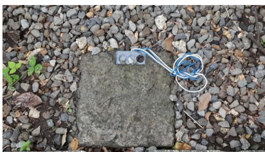
Sistema eléctrico para iluminación de jardines
