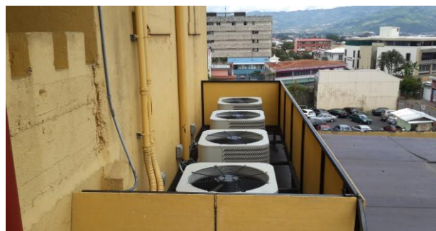
Mantenimiento de Aires Acondicionados
